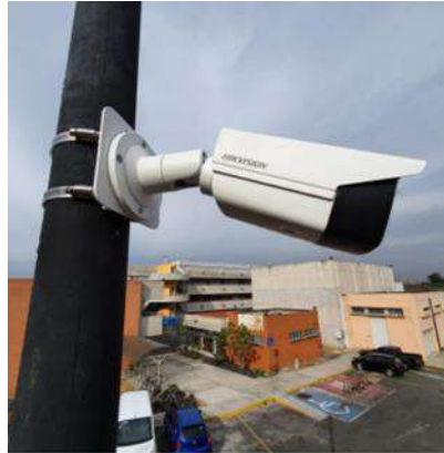
Ilustración 46. Instalación de cámaras IP
